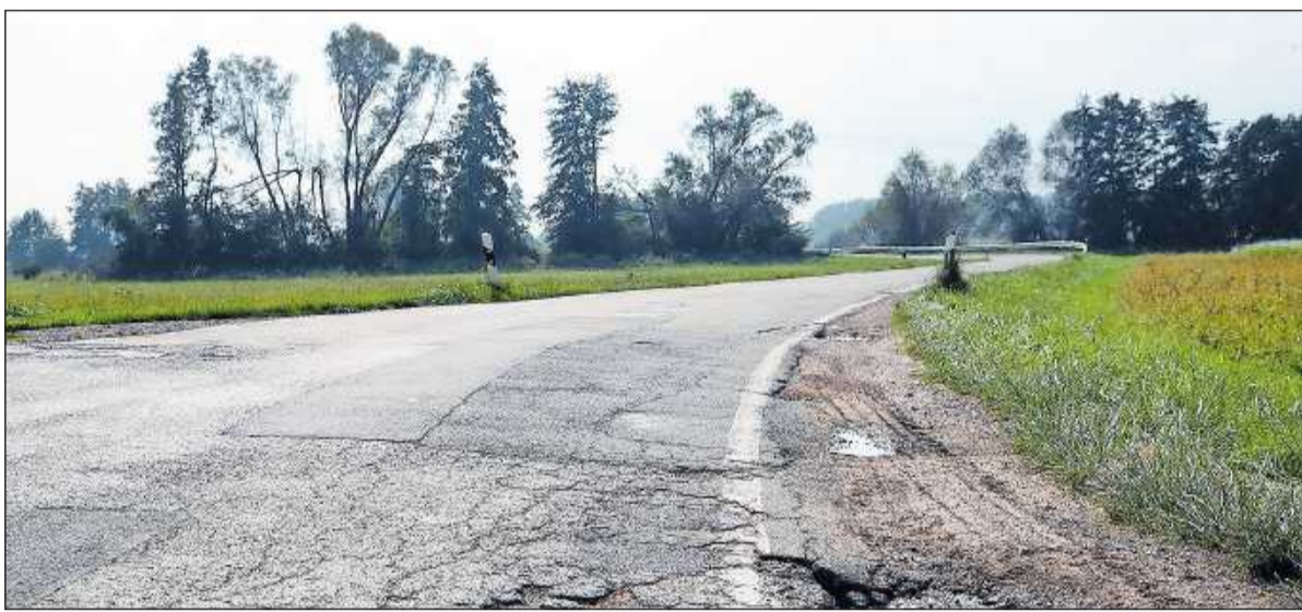
Die arg beschädigte Straße zwischen Gommersheim und Freisbach.
